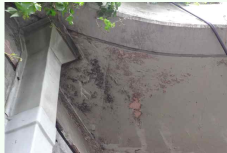
사진2 - S2 바닥판하면 도장들뜸
