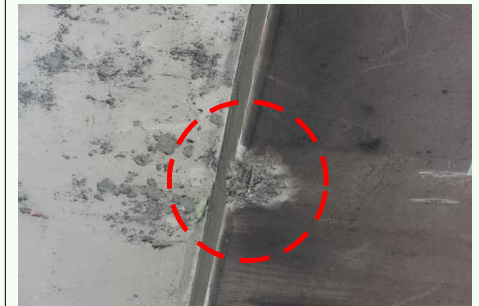
사진4 - S2 바닥판하면 파손
