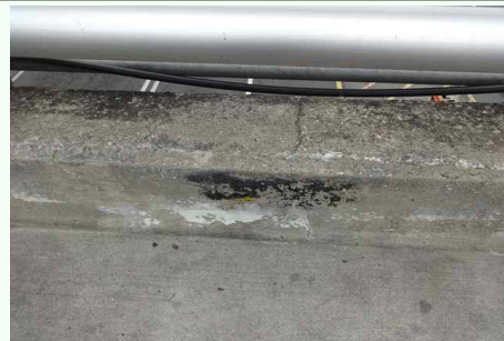
사진6 -S1 방호벽 연석 균열
