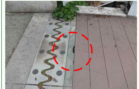
사진4 - 신축이음 후타재 파손
