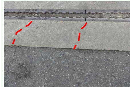
사진3 -A1 신축이음 후타재 균열
