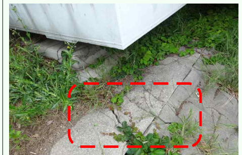
사진8-A2 교대 법면 파손
