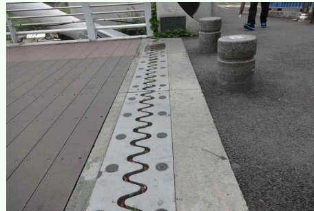
사진2 - 신축이음 후타재 망상균열
