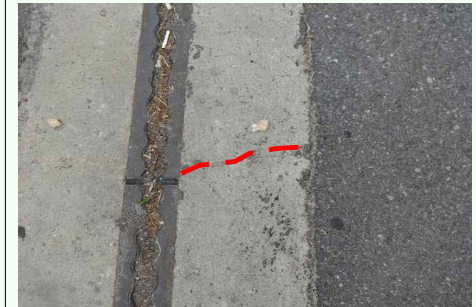
사진4 -A2 신축이음 후타재 균열
