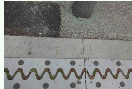
사진3 - 신축이음 후타재 균열
